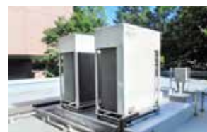
高効率EHP空調室外機
