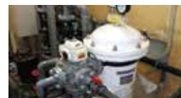
中水道システム
